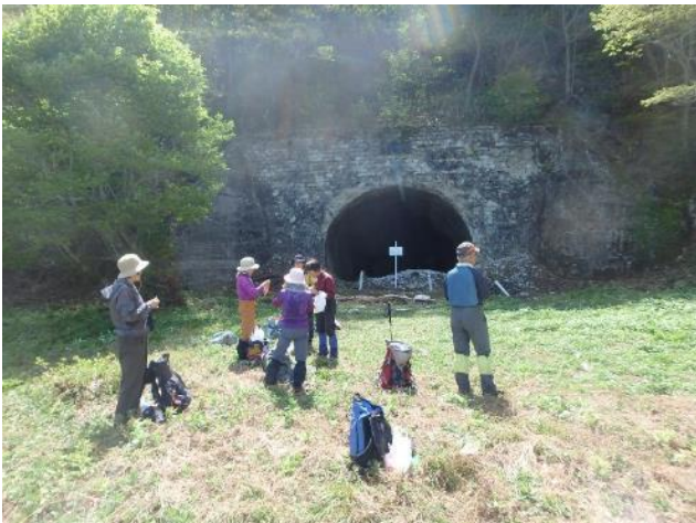
昭和前期に掘られた二代目も崩壊して通れない
