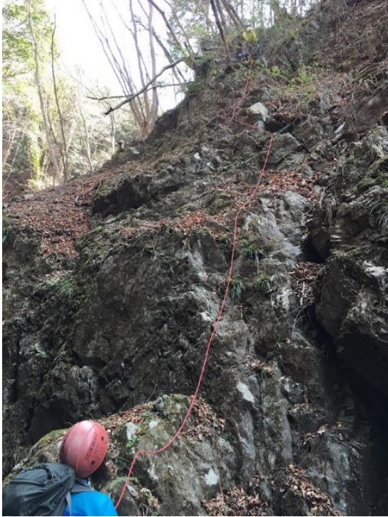
左岸巻き上部はボロボロ
